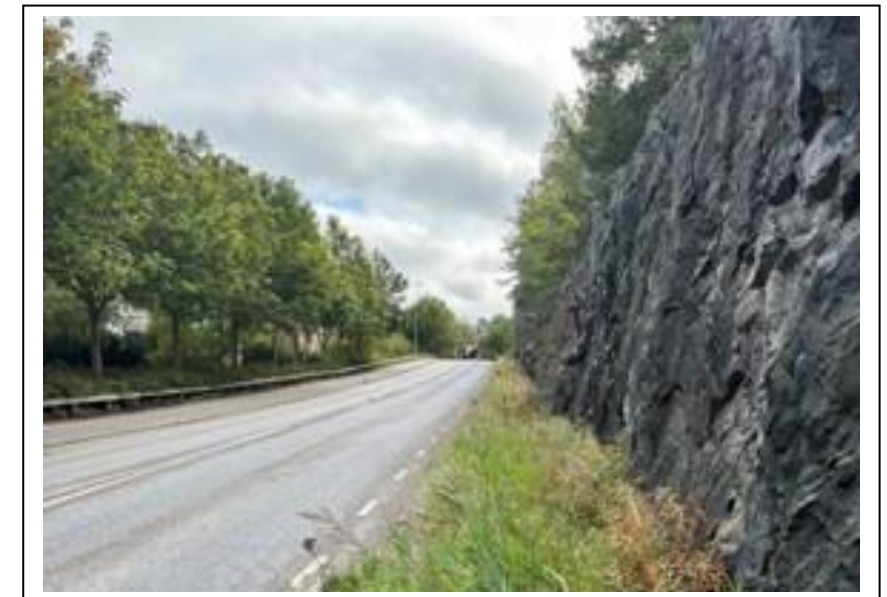
Figur 106. Dike utmed bergsfot på Kvarnholmsvägens södra sida.
